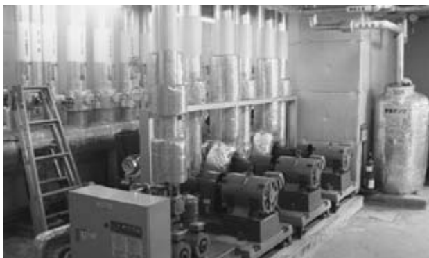
昭和庁舎の空調室
