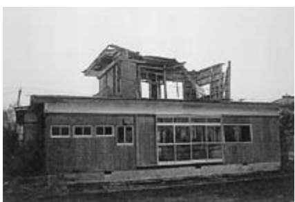
倒壊・飛散の恐れがある空き家
