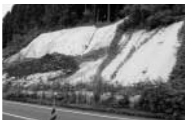
広域農道（市道秋田・五城目広域線）に努めて参ります。 の法面崩壊
