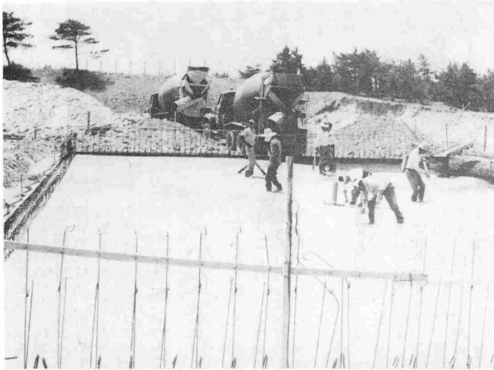
▲ミキサー車でコンクリートを流しプールの底面づくりに大わらわ (5月24日撮影)
